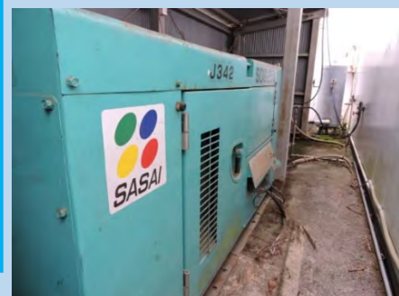
発電機を備える
