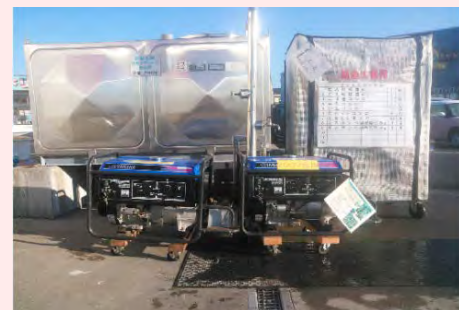
災害時用の発電機
