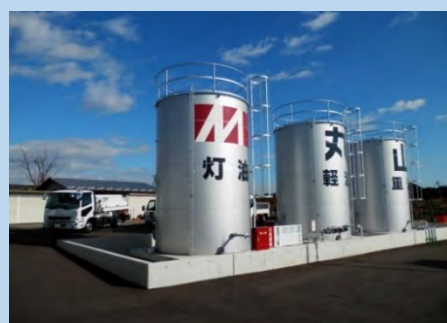
灯油・軽油・重油の石油備蓄タンク
