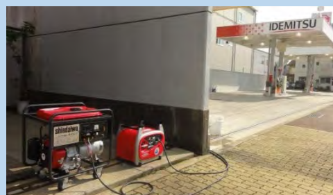
災害対策で自家発電機を配備
