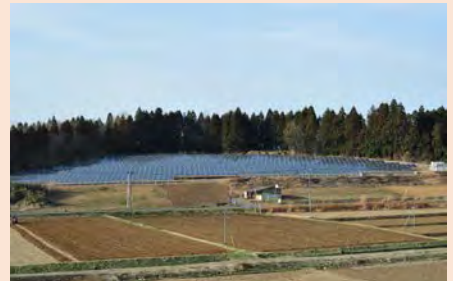
保土原第二太陽光発電所竣工写真フェンス内敷地面積8,330.66㎡、総発電量750kW、パワコン出力500kW
