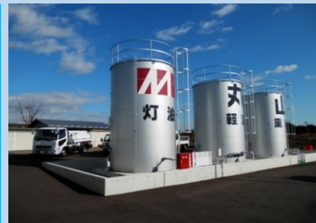
灯油・軽油・重油の石油備蓄タンク
